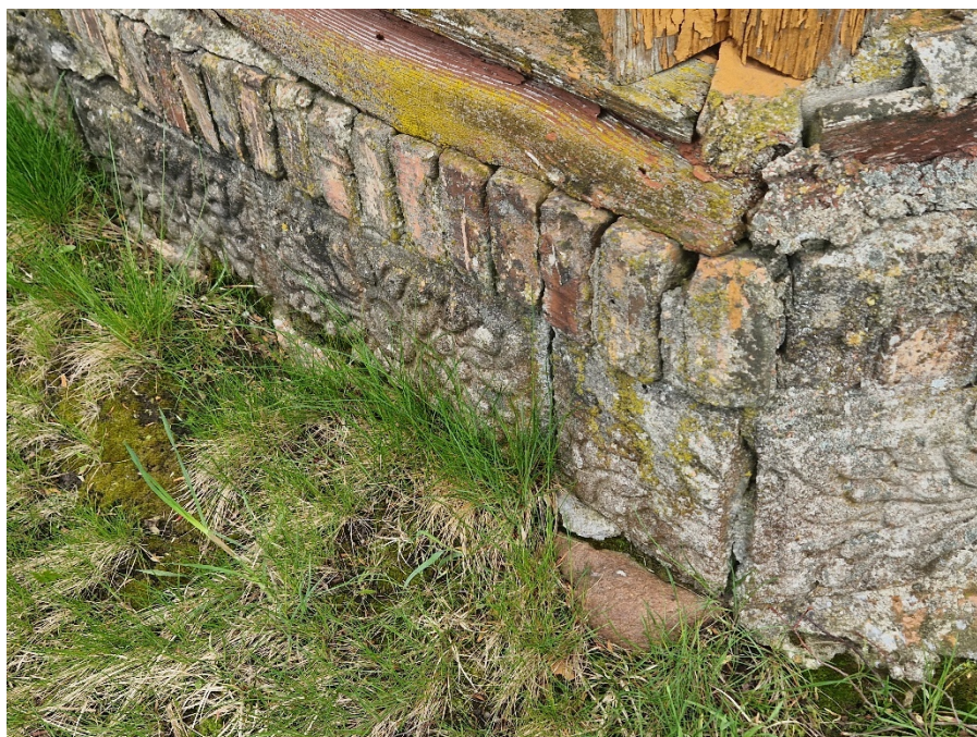
Fot. 8 Drewniana kapliczka w Przechodzisku, stan przed konserwacją 2024r, zbliżenie ukazujące część cokołową, widoczne zniszczenia i spękania części murowanej i podwaliny drewnianej.
