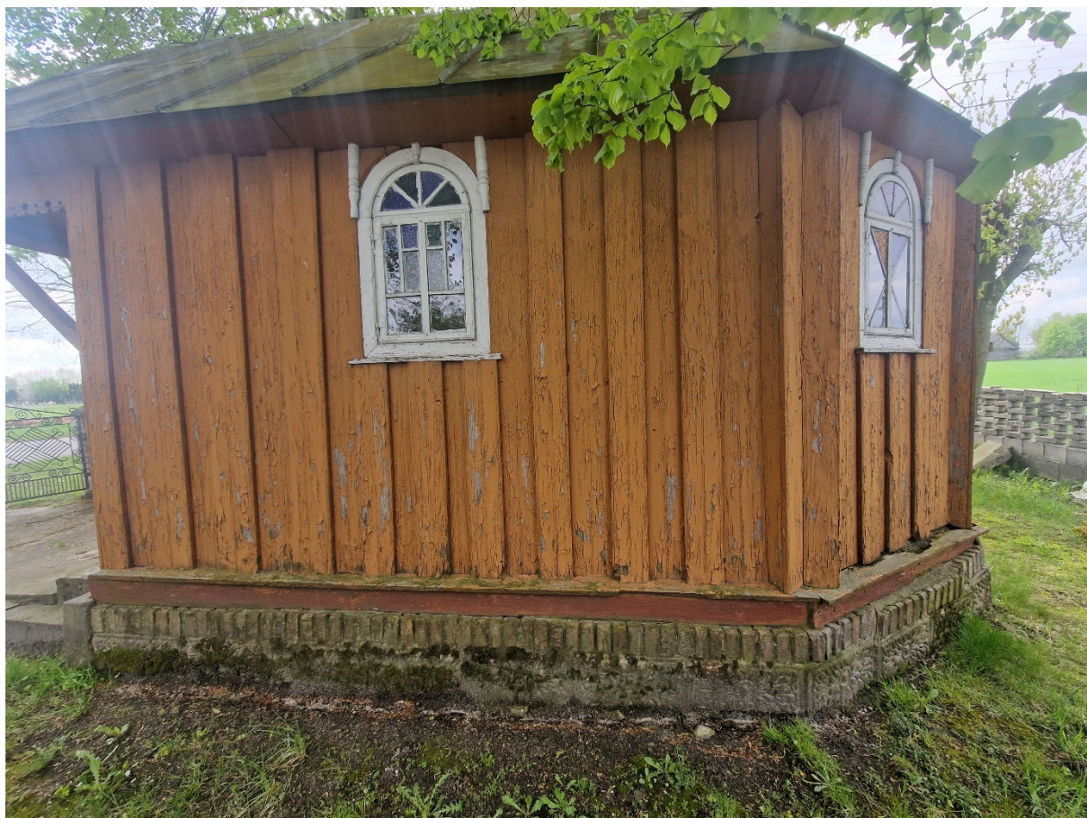
Fot. 11 Drewniana kapliczka w Przechodzisku, stan przed konserwacją 2024r, widok ogólny.
