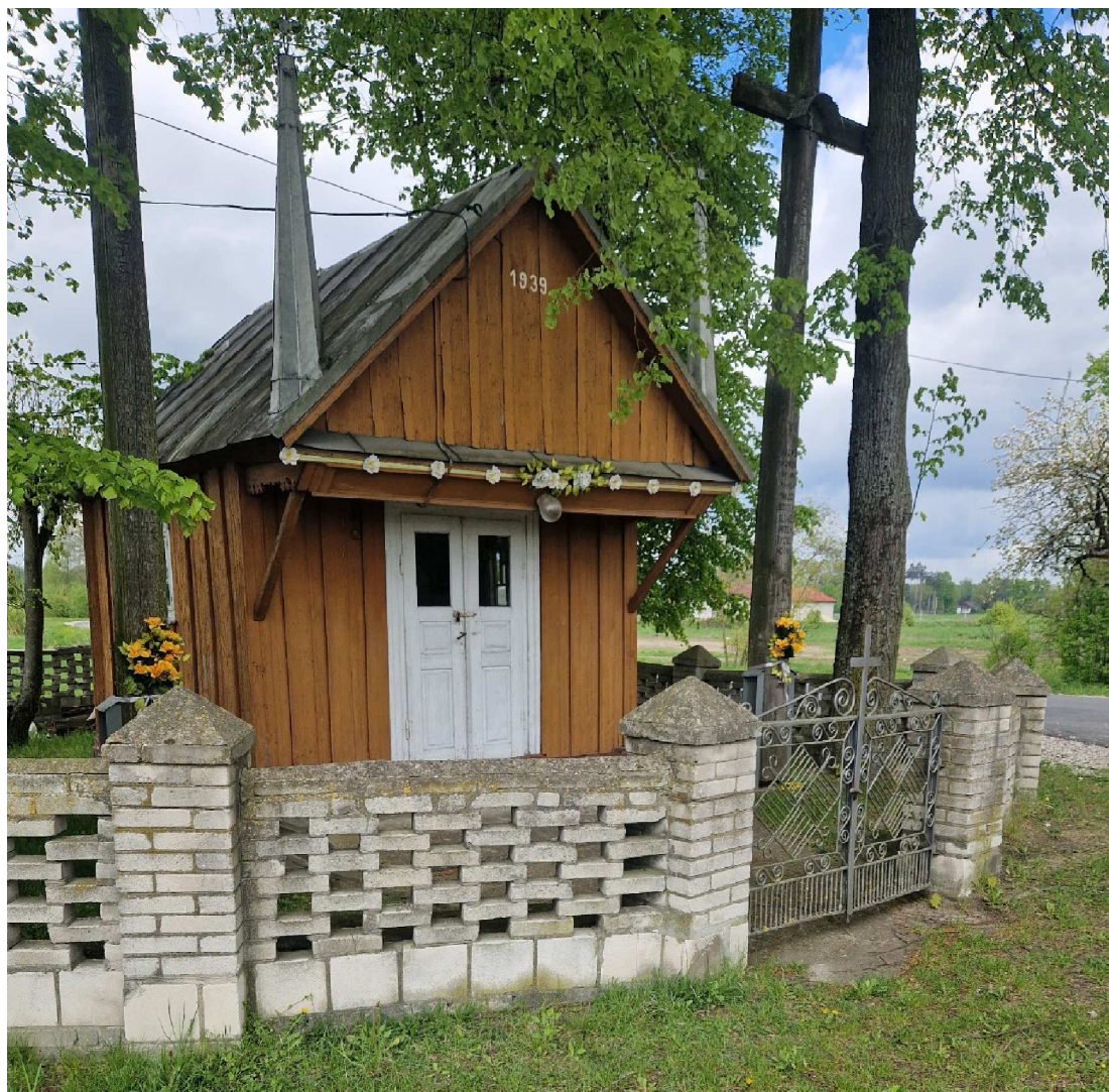
Fot. 10 Drewniana kapliczka w Przechodzisku, stan przed konserwacją 2024r, widok ogólny.
