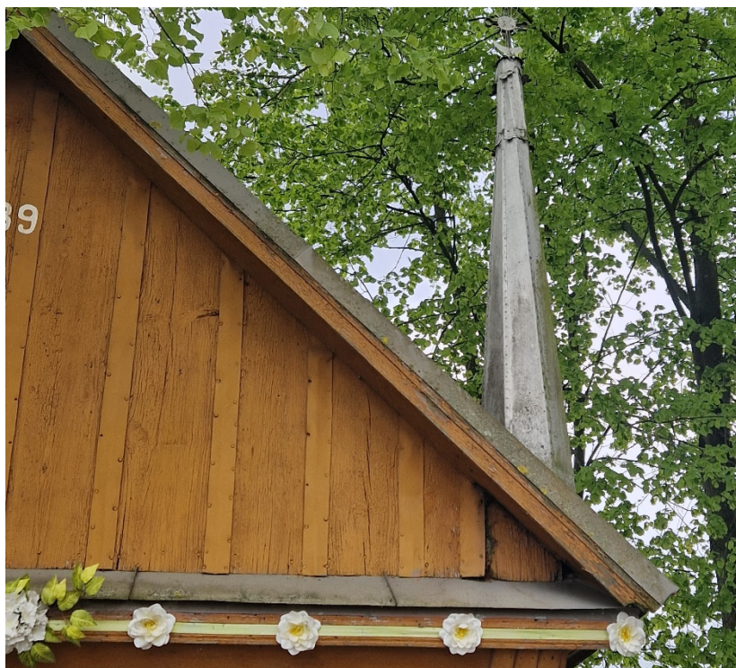
Fot. 6 Drewniana kapliczka w Przechodzisku, stan przed konserwacją 2024r, widok ukazujący zniszczenia metalowej sterczyny na dachu,
