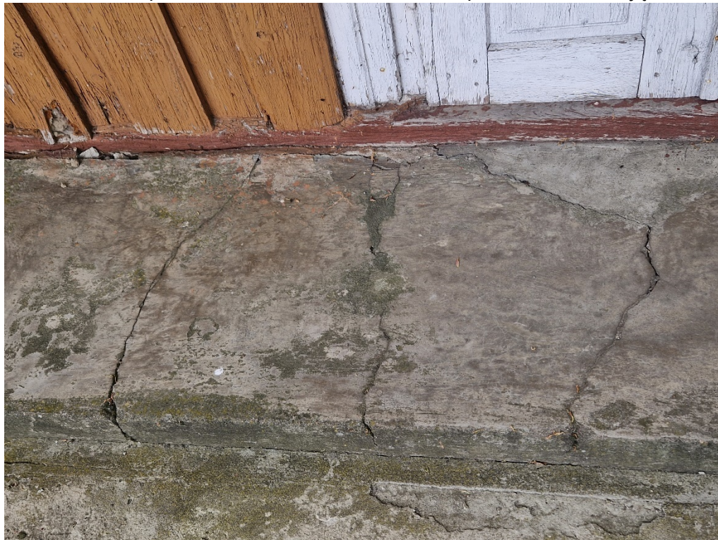
Fot. 7 Drewniana kapliczka w Przechodzisku, stan przed konserwacją 2024r, zbliżenie betonowego stopnia przy wejściu, widoczne spękania strukturalne.
