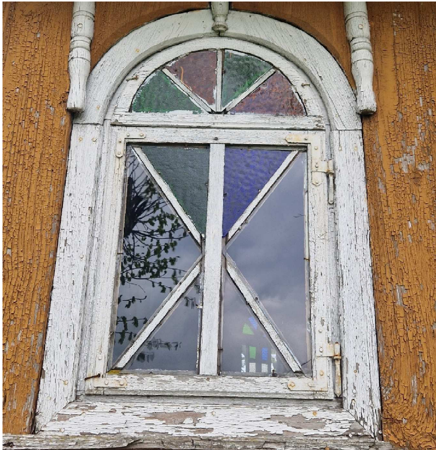
Fot. 5 Drewniana kapliczka w Przechodzisku, stan przed konserwacją 2024r, widok ukazujący zniszczenia okna.
