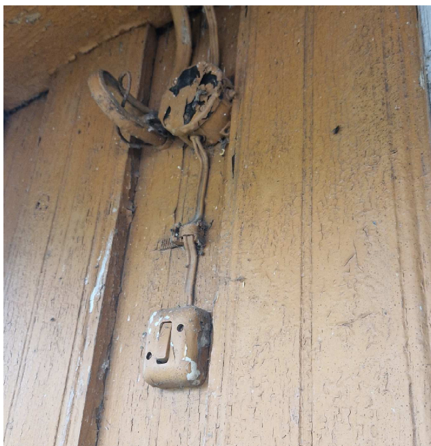
Fot. 15 Drewniana kapliczka w Przechodzisku, stan przed konserwacją 2024r, okablowania elektryczne.
