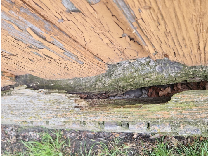
Fot. 3 Drewniana kapliczka w Przechodzisku, stan przed konserwacją 2024r, zbliżenie zniszczeń podwaliny.
