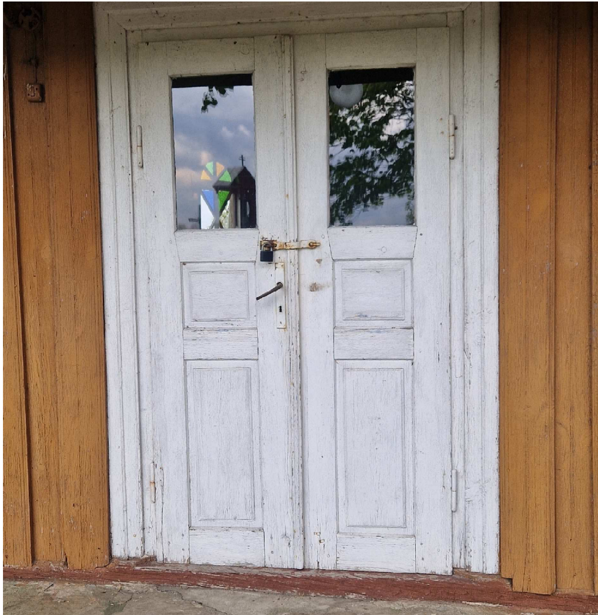
Fot. 18 Drewniana kapliczka w Przechodzisku, stan przed konserwacją 2024r, drzwi wejściowe.
