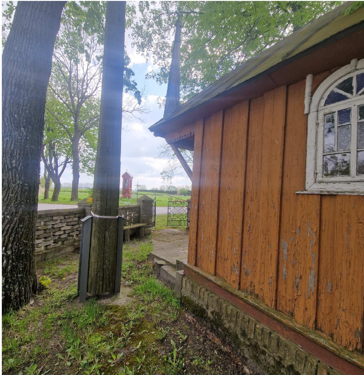
Fot. 12 Drewniana kapliczka w Przechodzisku, stan przed konserwacją 2024r, widok ogólny.
