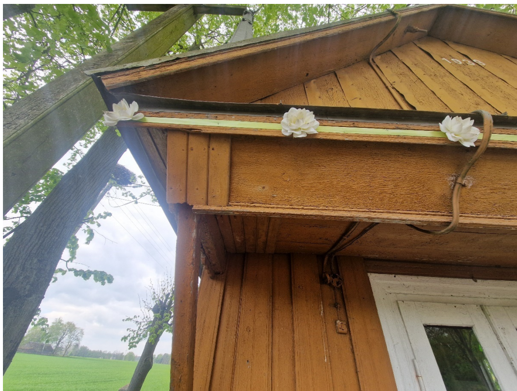
Fot. 14 Drewniana kapliczka w Przechodzisku, stan przed konserwacją 2024r, widok ukazujący ubytki podbitki ganku od lica i od spodu.
