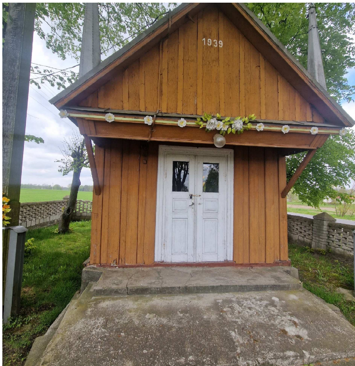
Fot. 13 Drewniana kapliczka w Przechodzisku, stan przed konserwacją 2024r, widok ogólny.
