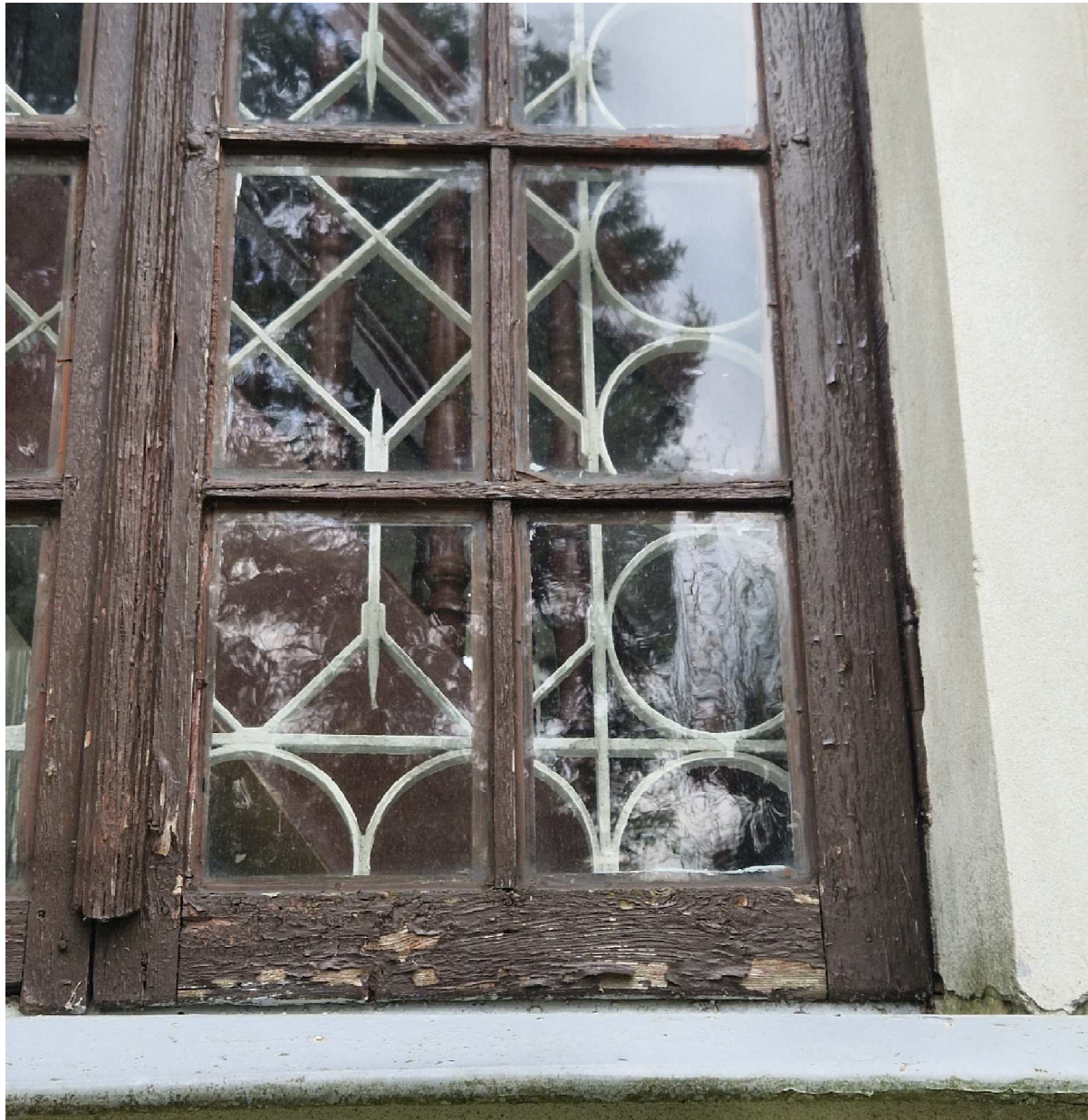
Fot. 10 Kościół p.w. Narodzenia N.M.P. w Szóstce, zbliżenie ukazujące zniszczenia konstrukcji stolarki okiennej.
