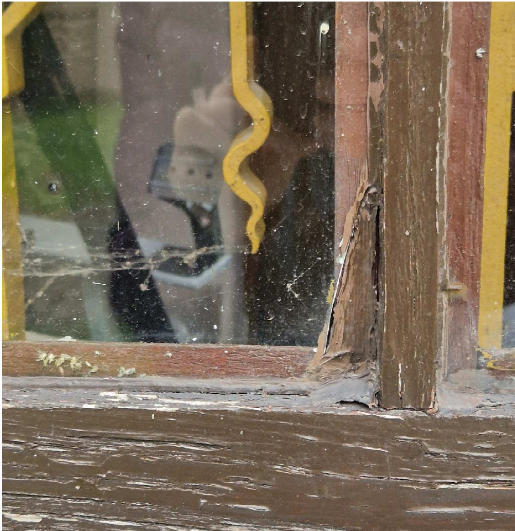
Fot. 4 Kościół p.w. Narodzenia N.M.P. w Szóstce, zbliżenie ukazujące zniszczenia konstrukcji stolarki okiennej i ubytki szklenia.
