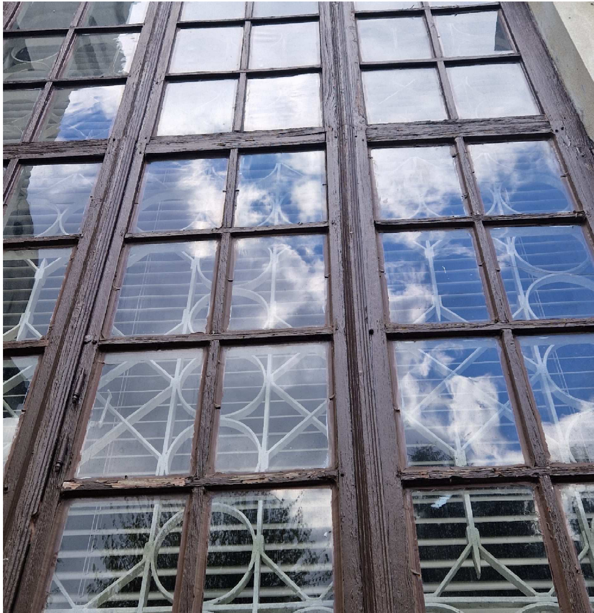
Fot. 13 Kościół p.w. Narodzenia N.M.P. w Szóstce, zbliżenie ukazujące zniszczenia konstrukcji stolarki okiennej.
