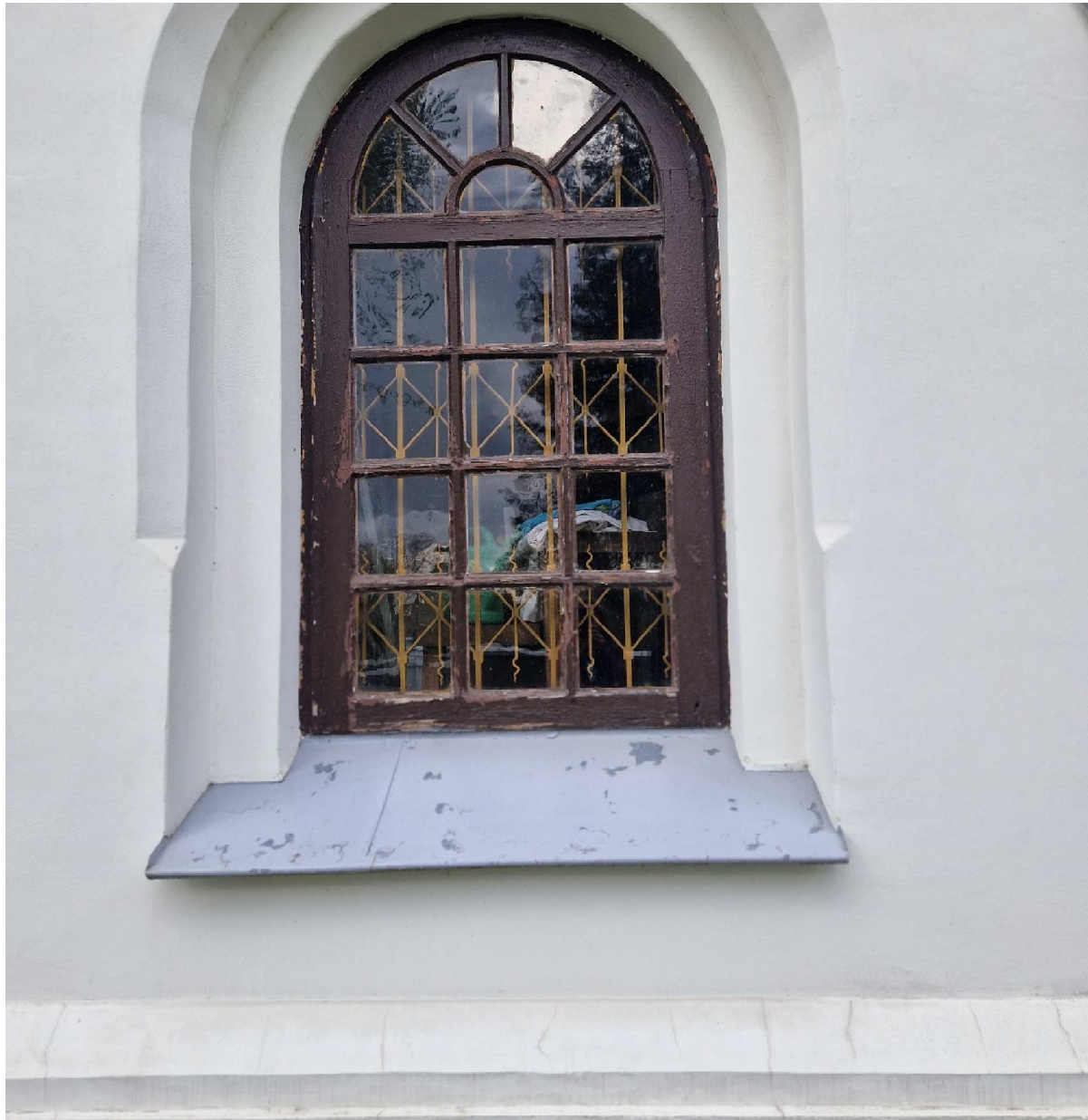
Fot. 14 Kościół p.w. Narodzenia N.M.P. w Szóstce, okna mniejszego rozmiaru, widoczne zniszczenia powłok malarskich.
