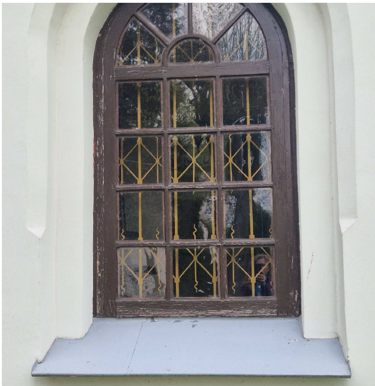
Fot. 9 Kościół p.w. Narodzenia N.M.P. w Szóstce, zbliżenie ukazujące zniszczenia konstrukcji stolarki okiennej.
