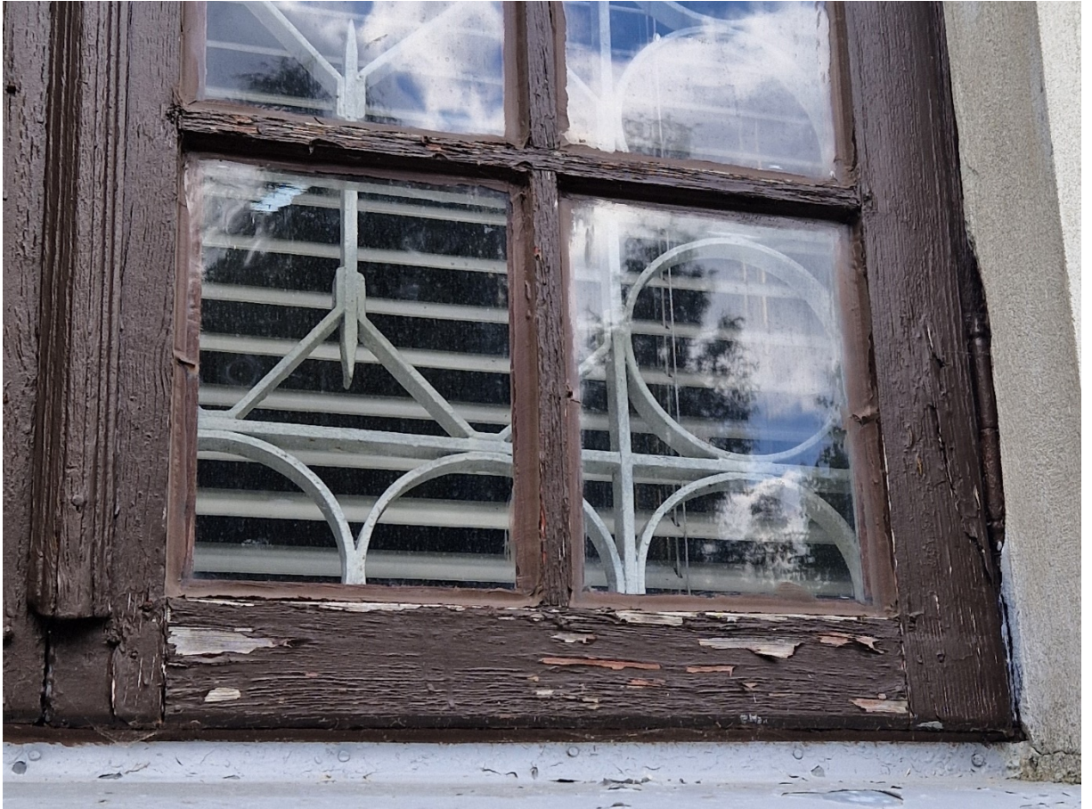
Fot. 3 Kościół p.w. Narodzenia N.M.P. w Szóstce, zbliżenie ukazujące zniszczenia konstrukcji stolarki okiennej.
