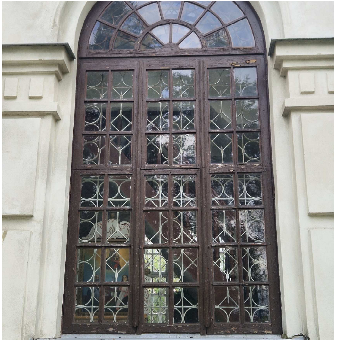
Fot. 11 Kościół p.w. Narodzenia N.M.P. w Szóstce, zbliżenie ukazujące zniszczenia konstrukcji stolarki okiennej.
