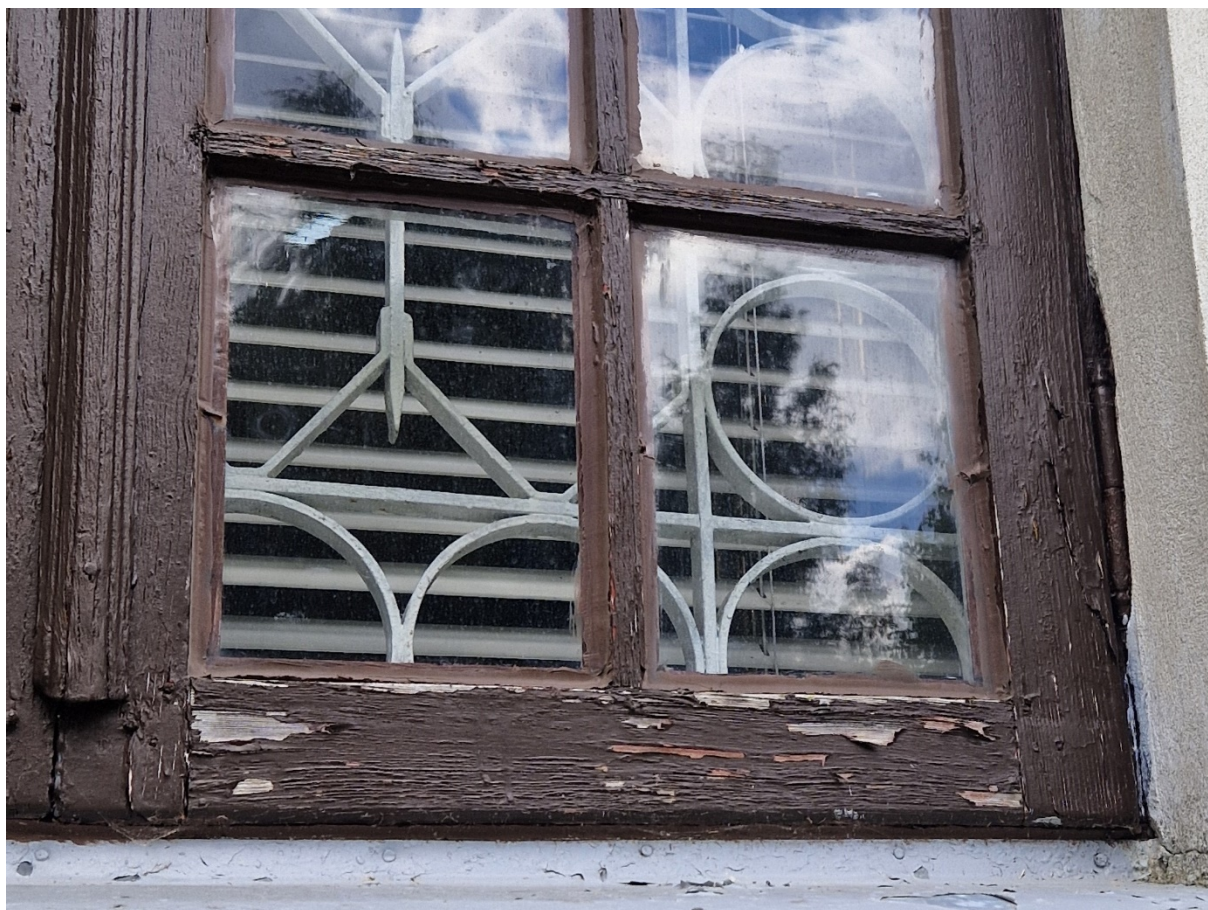
Fot. 15 Kościół p.w. Narodzenia N.M.P. w Szóstce, zbliżenie ukazujące zniszczenia konstrukcji stolarki okiennej.
