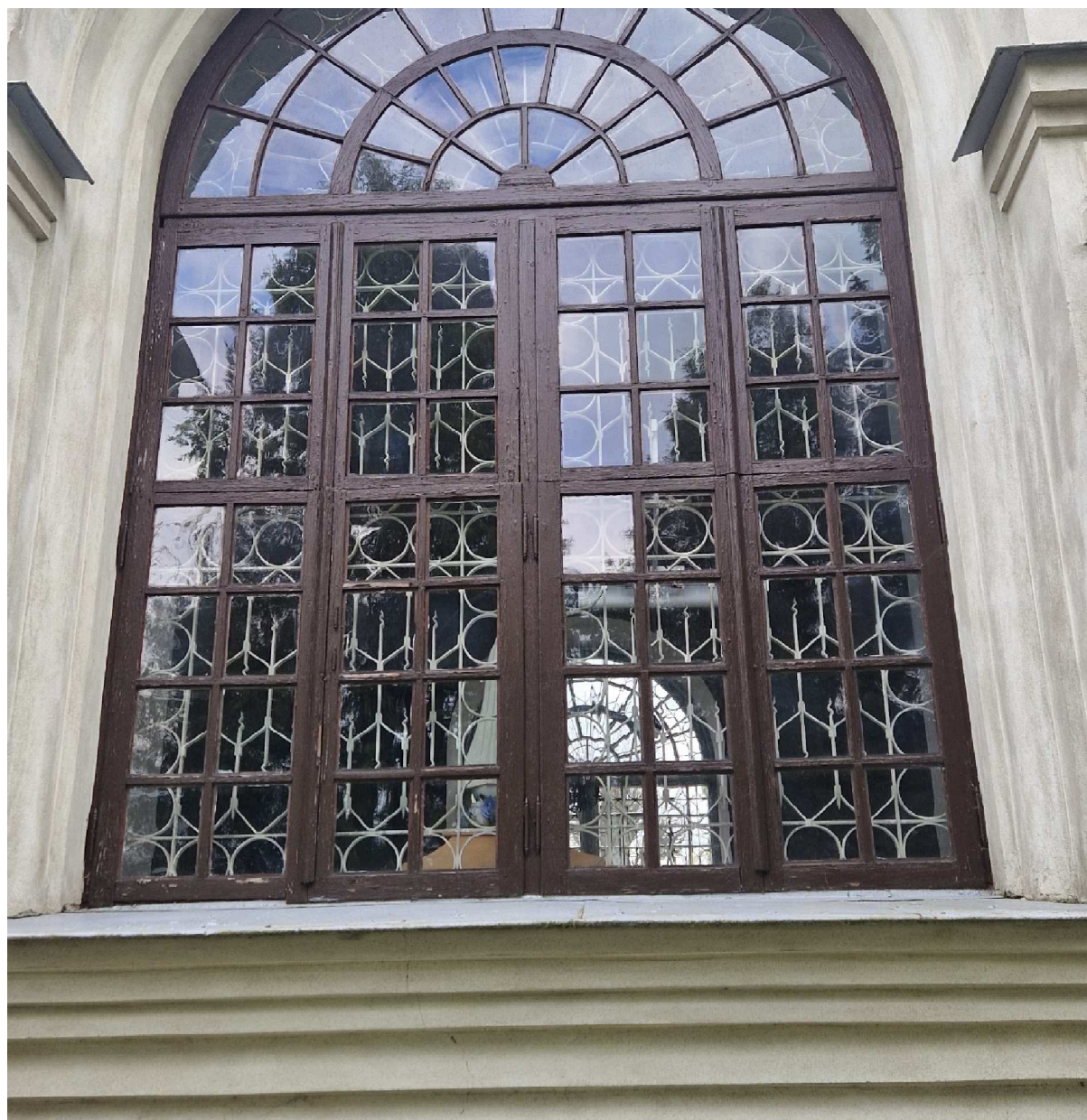
Fot. 12 Kościół p.w. Narodzenia N.M.P. w Szóstce, zbliżenie ukazujące zniszczenia konstrukcji stolarki okiennej.
