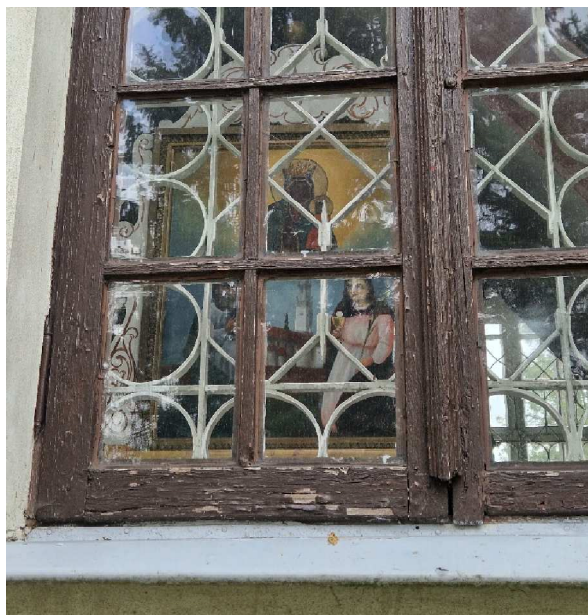
Fot. 2 Kościół p.w. Narodzenia N.M.P. w Szóstce, zbliżenie ukazujące zniszczenia konstrukcji stolarki okiennej.
